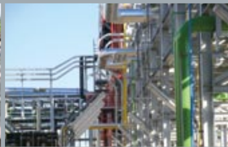
Planta de cogeneración de Cepsa en La Rábida.
